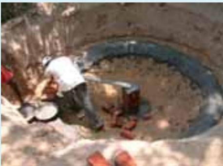
In der indischen Region Tamil Nadu entstehen rund 900 Gärkuppeln, in denen die Bauern ihren Kuhdung vergären. Das entstehende Biogas wird direkt in die Häuser geleitet, wo es auf einfachen Kochern verfeuert wird.
