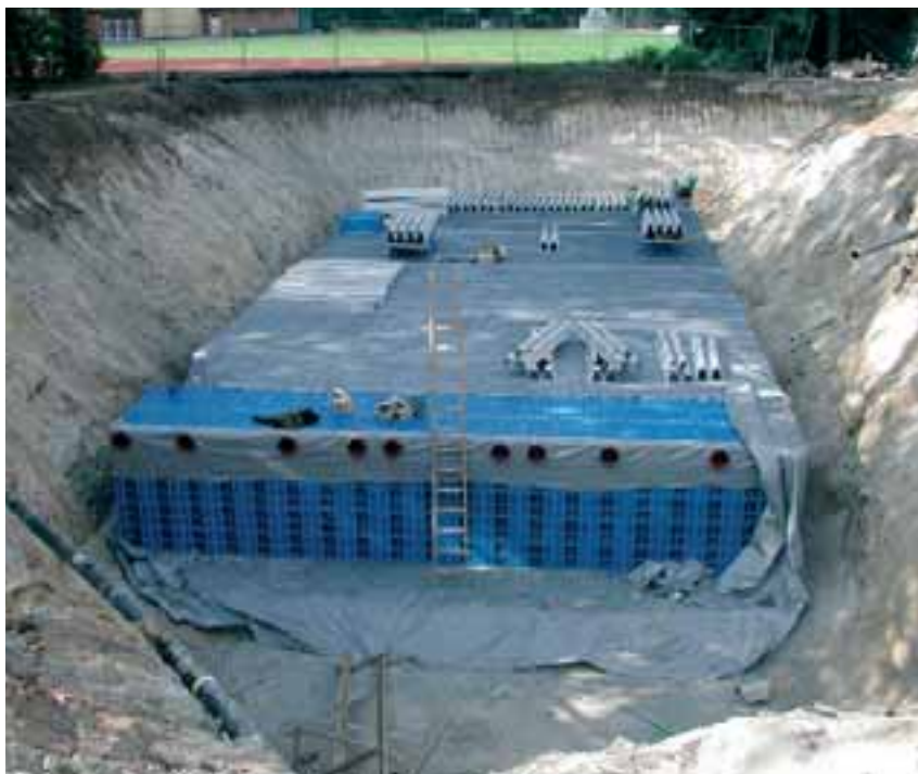
Unterirdische Versickerungsanlagen – wie hier im Stadion Frankfurt – speichern Regenwasser und führen es nach und nach in den natürlichen Wasserkreislauf zurück.
