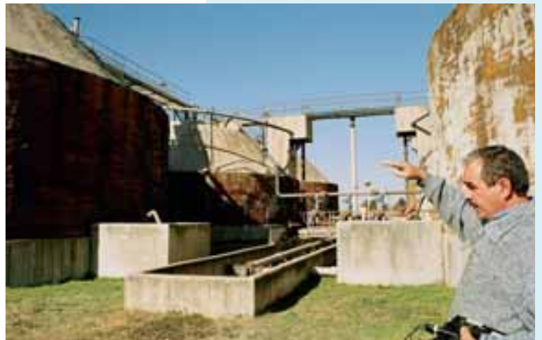
Kläranlage beim Sebokeng Township in der Nähe von Johannesburg, Südafrika.
